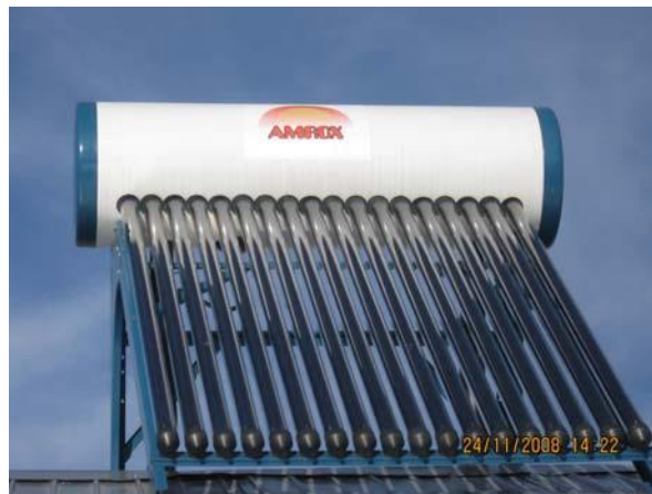
Panouri solare apa calda
